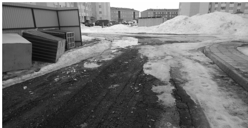
Трещины на асфальте, положенном ДРСУ. Кто ответит за это?
