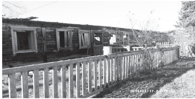
ул. Строителей, сгоревший барак №7
